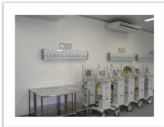
Adequação de área física no edifício da FMUSP, para implantação da Unidade Experimental de Terapia Intensiva.
