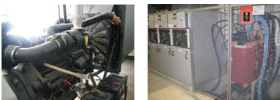
Cabines de transformação após a reforma
