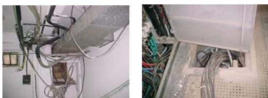
Cabines de transformação antes da reforma
