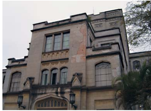
Nos detalhes, aspectos da fachada: paredes descascadas, telhado impróprio e equipamentos instalados em locais errados.
