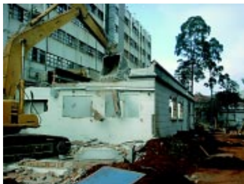
Três cenas momentos das obras no Pavilhão de Serviços, incluindo, na foto abaixo, a demolição do Grêmio dos funcionários.
